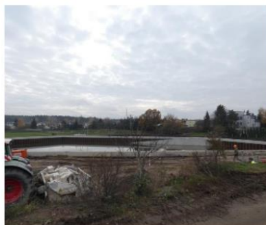
Zbiornik wód deszczowych na osiedlu Nowe Krosno w Mosinie
